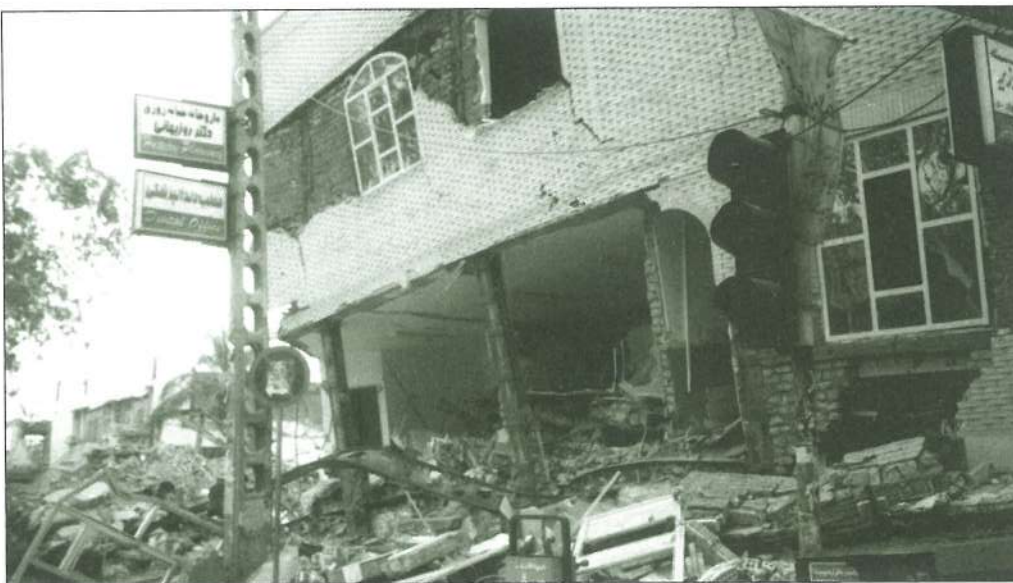
نداشتن سیستم باربر جانبی مناسب آسیب دیدگی شدید زلزله بم ۸۲/۱۰/۵
